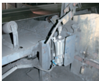
DSBG jako siłownik uderowy: siłownik o dużej średnicy tłoka do oczyszczania podajnika taśmowego w elektrowni zapewnia bezproblemowy transport węgla do kotłowni.
