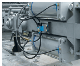
Dopływ powietrza: odpowiednio dobrany napęd DSBG do regulacji kłapy w celu optymalizacji zasilania dopływu powietrza w procesie spalania.
