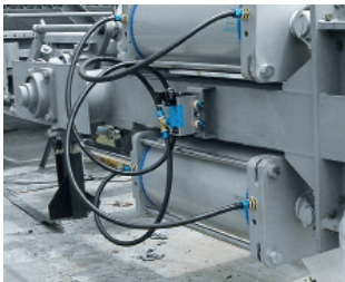
供气：DSBG 驱动风门进行相应的供气，优化燃烧。
