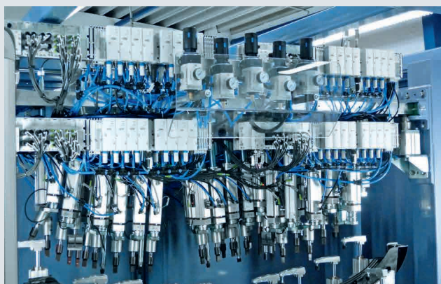
Máxima funcionalidad, mínima necesidad de espacio: VPPM-MPA integrada en el terminal eléctrico CPX/MPA
