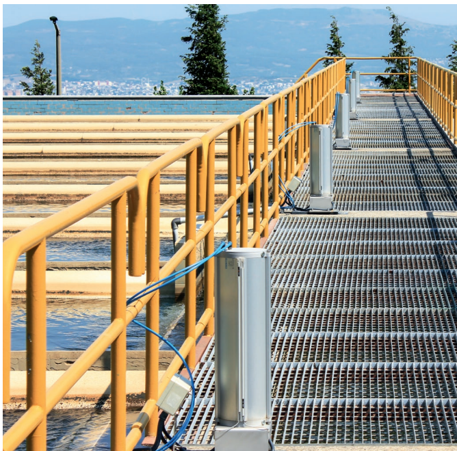
Los actuadores lineales de Festo regulan el llenado y el vaciado de las 28 pilas filtrantes.
