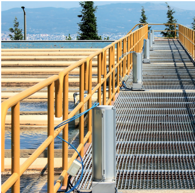
Linearantriebe von Festo regeln den Zu- und Ablauf der insgesamt 28 Filterbecken
