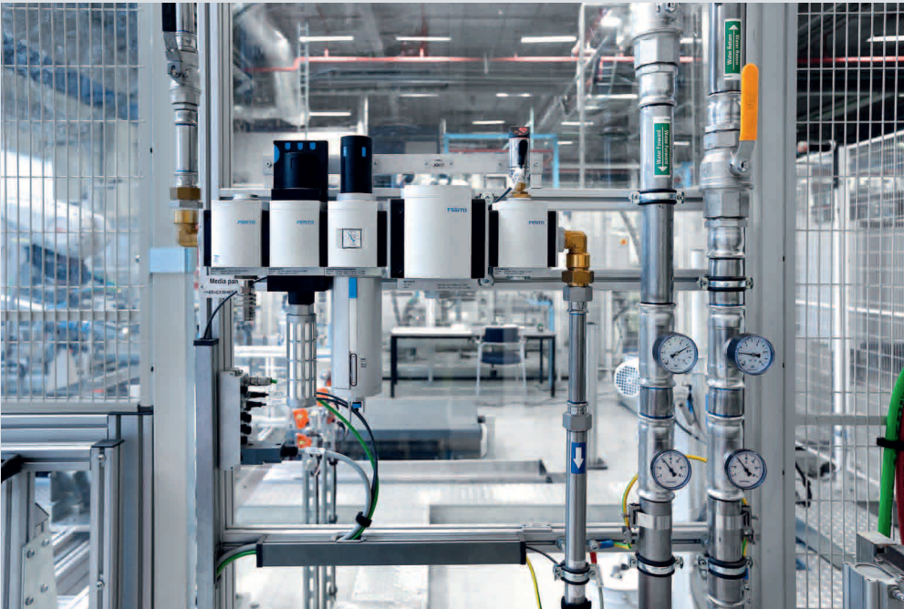
Bedienerfreundlich im Sicherheitszaun integriert: einbaufertige Komplettlösung zur Druckluft- und Kühlwasserversorgung von Schweißzangen, inklusive Druckluftaufbereitung der MS-Reihe.
