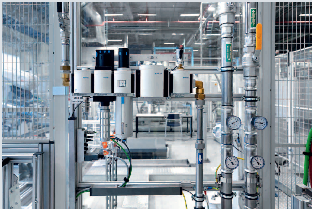
Ergonomía integrada en la zona circundada por rejas de seguridad: solución completa lista para su instalación, para la alimentación de aire comprimido y de agua refrigerante a las mordazas de soldadura, incluyendo la preparación de aire comprimido de la serie MS.
