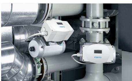
Positionnement de vannes pour le contrôle de débit
