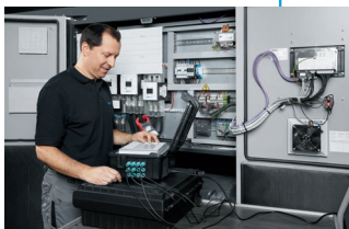
Análisis de la generación de aire comprimido
