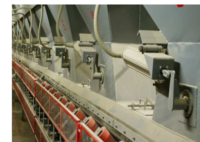
Contrôle du déversement des silos lors du traitement des engrais
