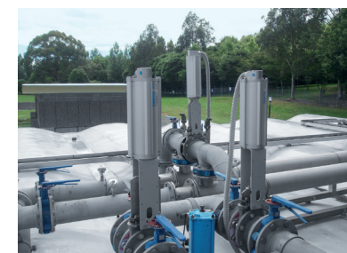
Vanne contrôlée pour le débit des boues de retour dans une station d'épuration des eaux usées
