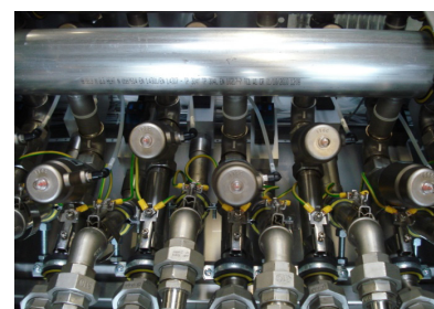
Systèmes de refroidissement par eau
