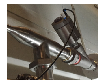
Contrôle d'arrêt pour le glycol utilisé dans la production alimentaire
