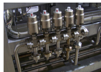
Lavage et remplissage des fûts
