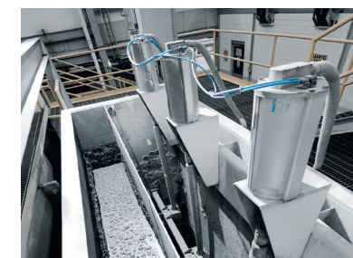
Contrôle de la vanne à fléchette pour la régulation du niveau dans le traitement des minéraux
