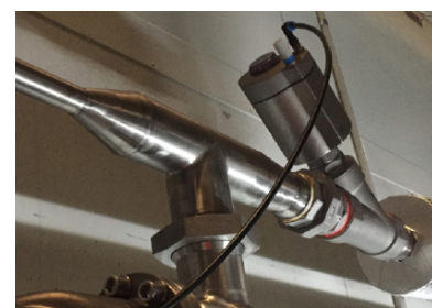
Contrôle d'arrêt pour le glycol utilisé dans la production alimentaire
