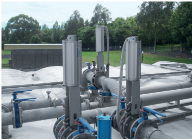
Puerta de desagüe controlada para el caudal de lodos de retorno en una planta de tratamiento de aguas residuales
