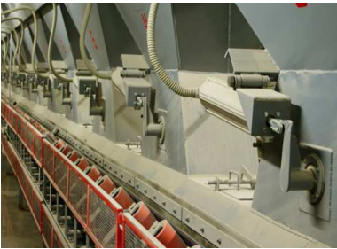
Control de la descarga de silos en el procesamiento de fertilizantes
