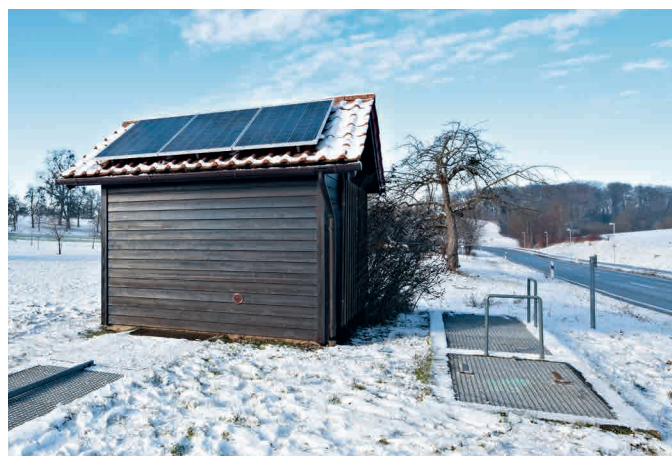
Solarpanels versorgen die Steuerung der Regenrückhaltebecken bei Esslingen mit Strom.
