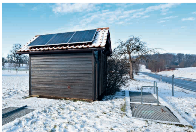
Los paneles solares suministran electricidad al controlador del depósito de aguas pluviales en Esslingen.
